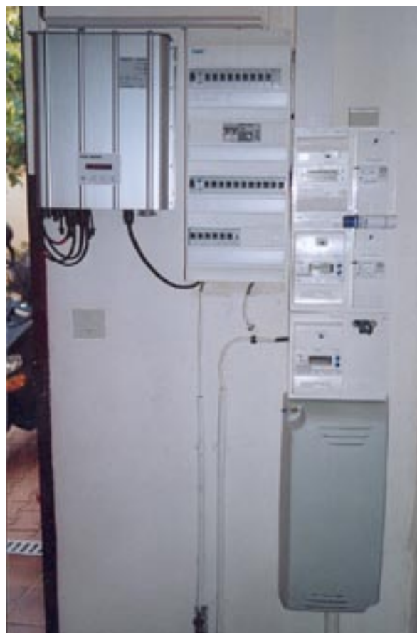
Onduleur et compteur de production
