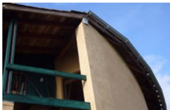
Gouttière en zinc à Saint-Quentin -la-Poterie
