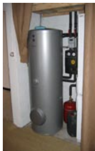
Ballon de stockage eau chaude
