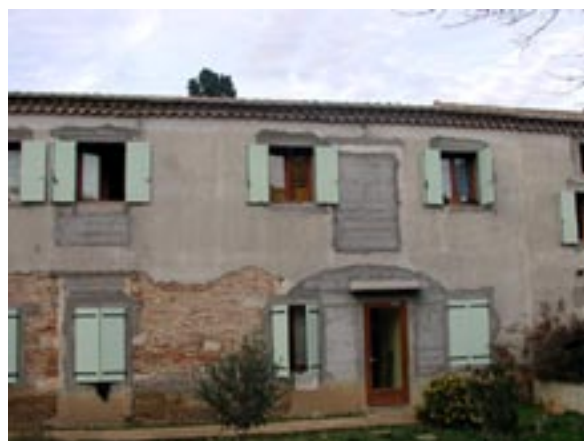
Une rénovation niant le vocabulaire architectural d'origine
