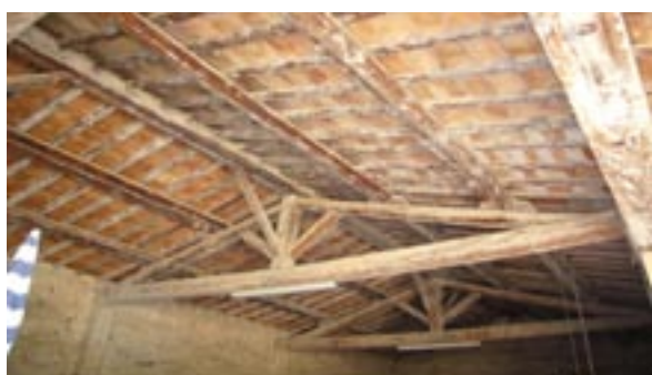
Mas du Notaire : charpente en bois et parefeuilles de terre cuite constituent le support de couverture
