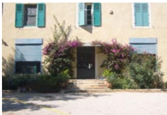
Château Beauvois : cohabitation de volets roulants avec les volets traditionnels repliables en façade : un choix à éviter
